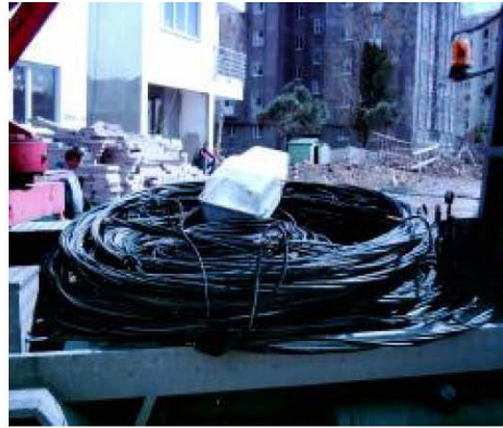
Resim 1.7: Alpek kablonun taşıt üzerindeki görünüşü
